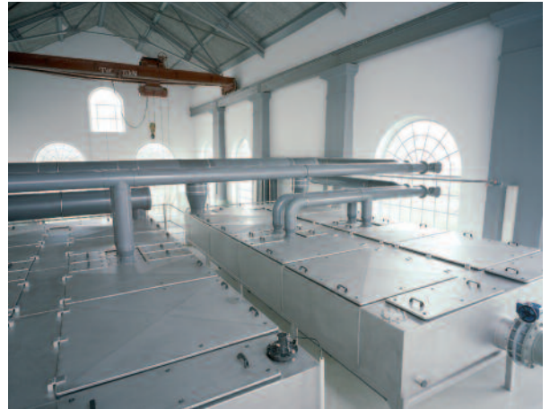
Installation de Kassel : 2 x 300 m 3 /h
