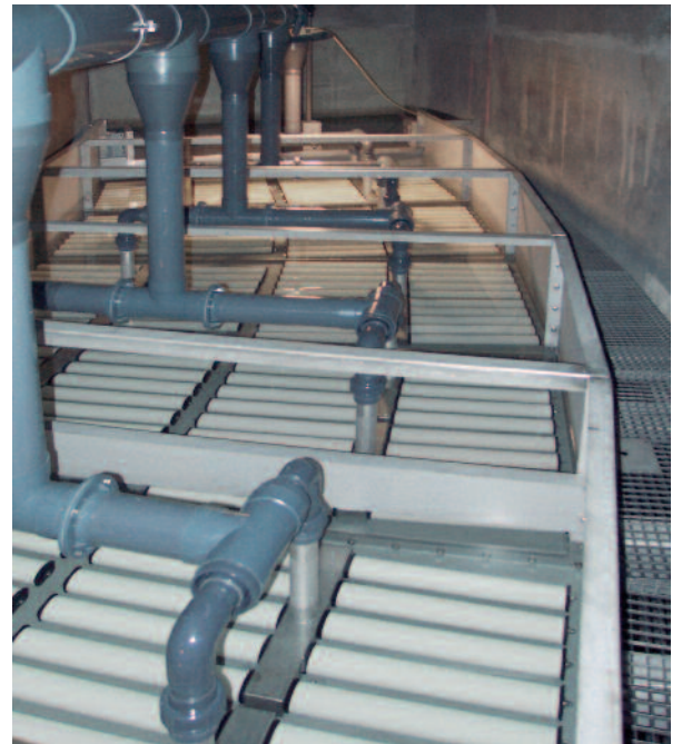
Installation de Düsseldorf : 2 000 m 3 /h
